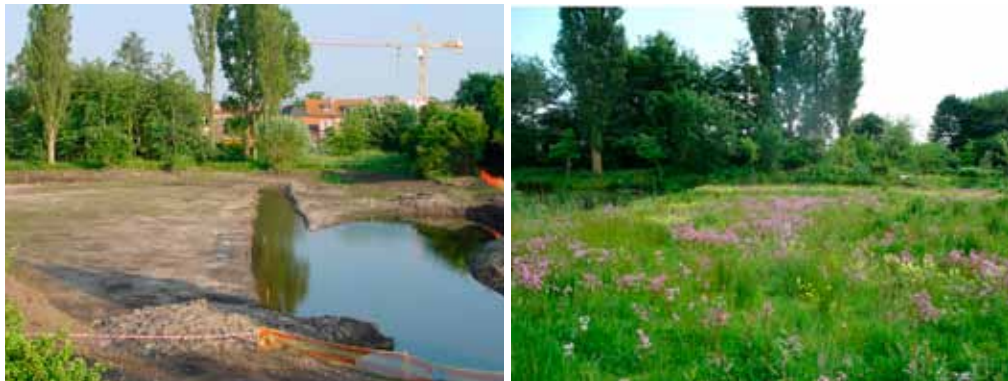
Figuur II.38: Eenmalige inrichtingswerken in het Sint-Baafskouterpark (Gent): herstellen walgracht, afgraven voedselrijke bovenlaag en inzaai met inheems bloemenweidemengsel. Op de rechterfoto vallen Echte koekoeksbloem ( Lychnis flos-cuculi ) en Grote ratelaar ( Rhinanthus major ) op (Sint-Baafskouterpark, Gent, foto: Fris in het Landschap).
